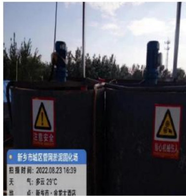
药剂罐现场图
