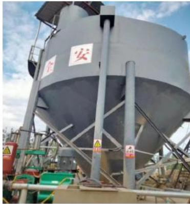
絮凝罐、柱塞泵现场图
