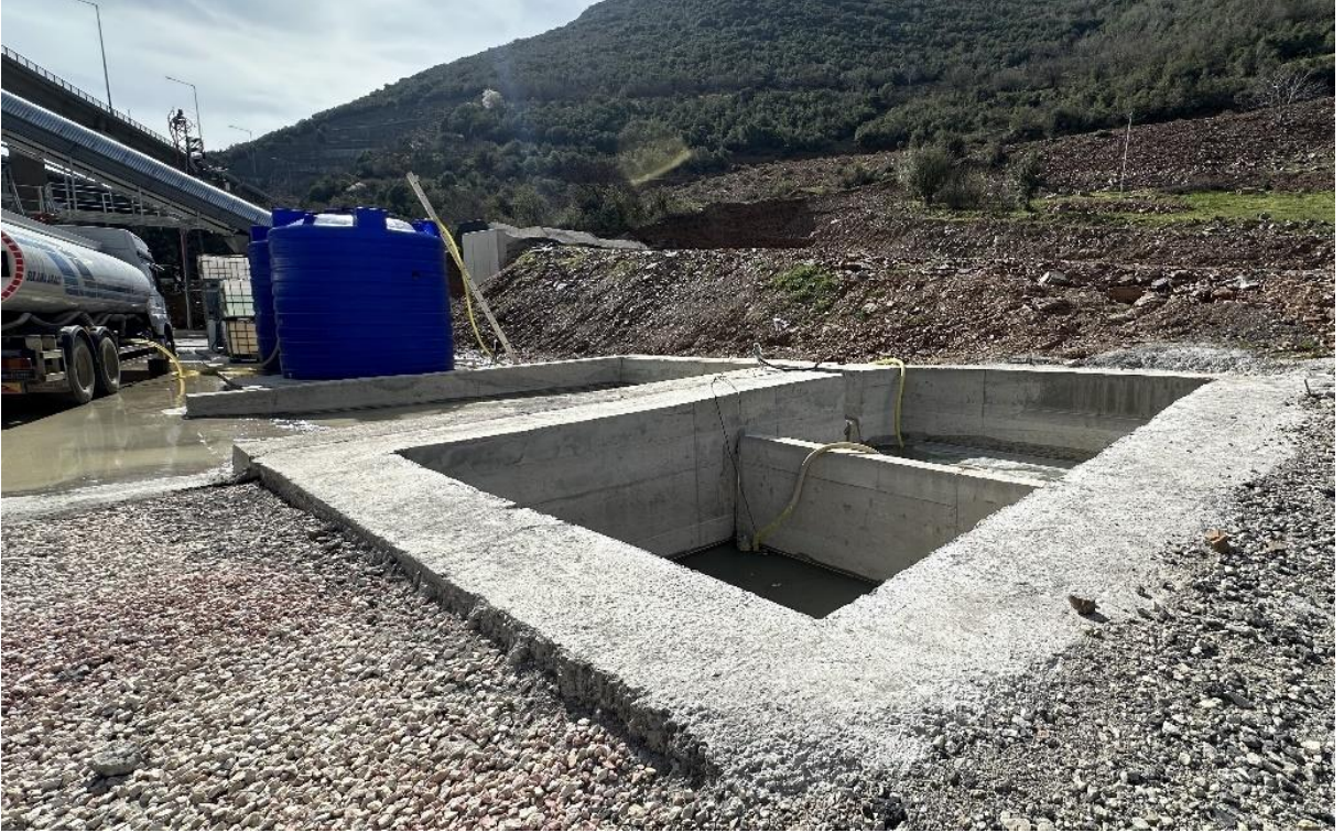
Şekil 9. Bahçe Ayran Beton Tesisi Kademeli Çöktürme Havuzu
