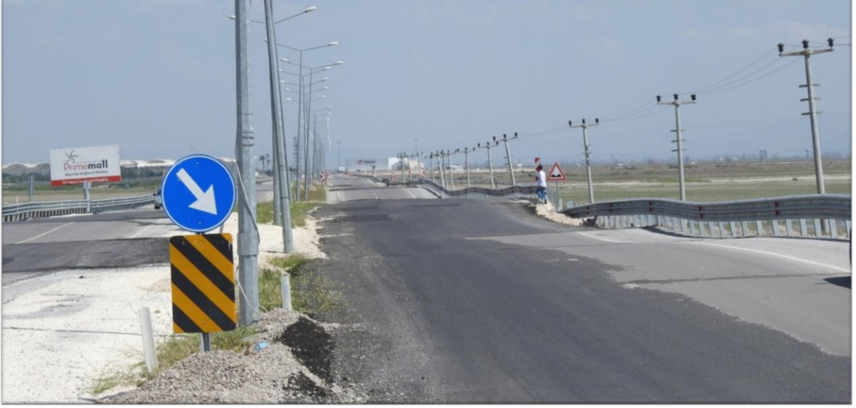
Şekil 19. Hatay Havalimanı Yolunun Deprem Sonrası Görünümü (Km:2+840-3+480)
