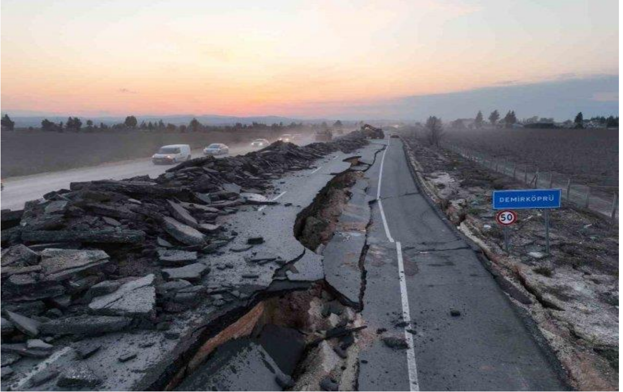
Şekil 14. Demirköprü'nün Depremden Sonraki Görüntüsü
