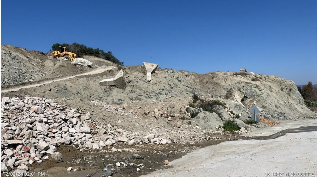
Şekil 28. Heyelan Islah Çalışmaları
