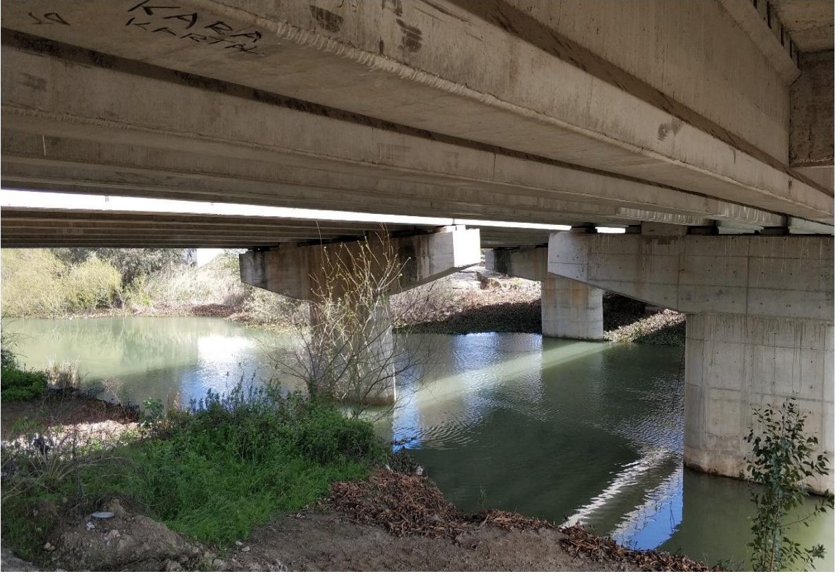
Şekil 13. Demirköprü Ayaklarındaki Hasar
