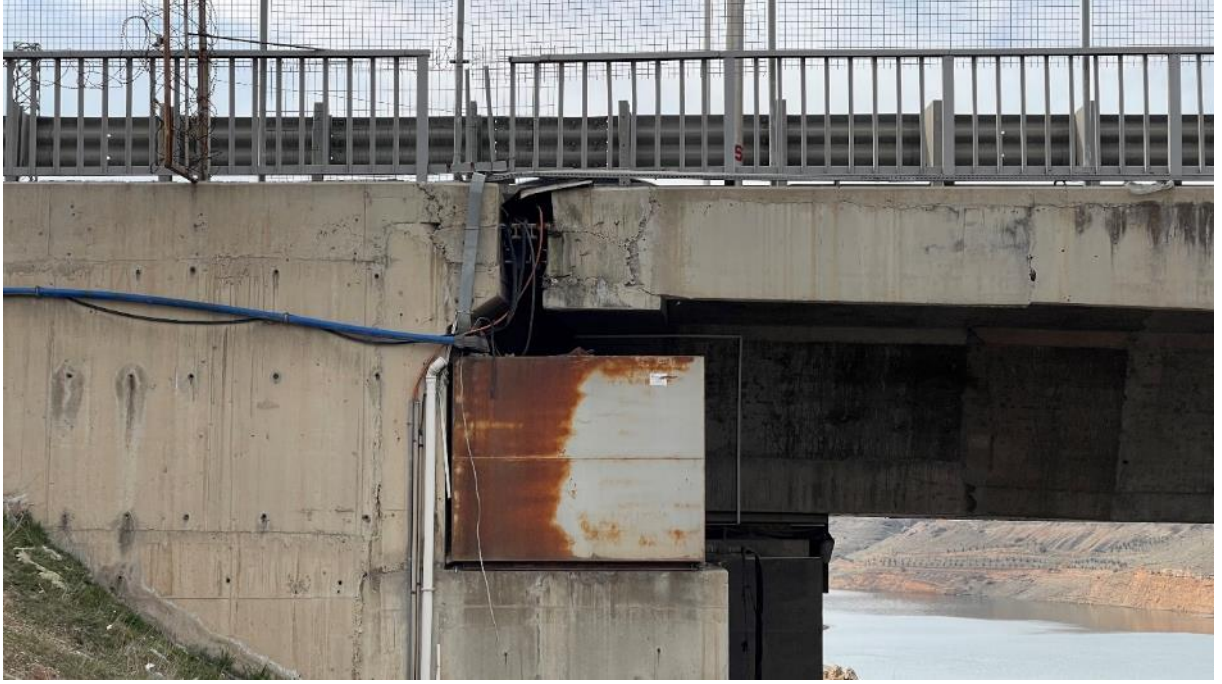
Şekil 40. Beylerderesi Köprüsü – Köprü Hasarı
